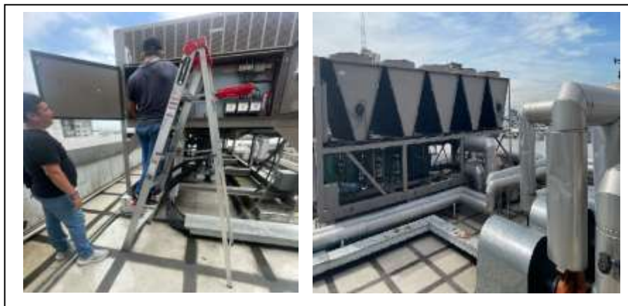
Figura 4. Equipos de climatización de edificio Montecristi
